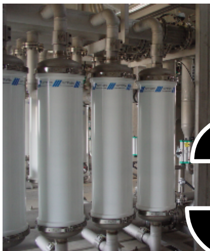
●岩崎浄水場の膜処理施設
