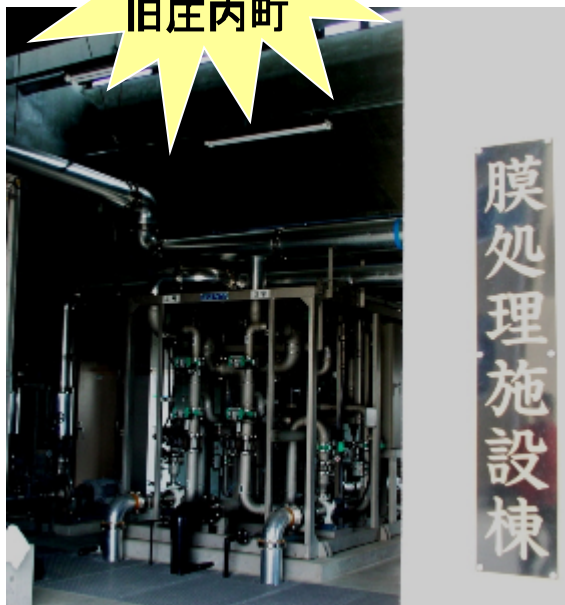
事件の舞台となった岩崎浄水場高度膜処理施設
